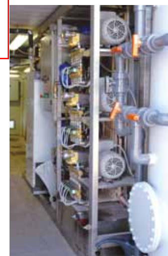
Оборудование на 3 поста
