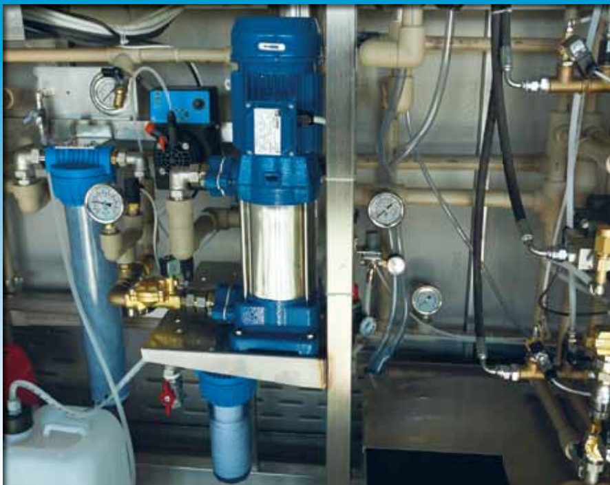
Фильтр и насос системы обратного осмоса
